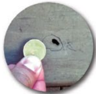
Orificio de emergencia en madera.
