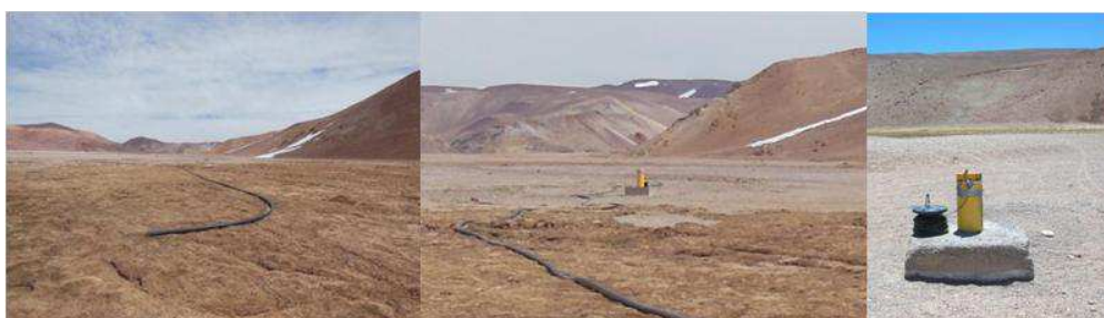
Figura N°71. De izquierda a derecha, tubería y pozos.
