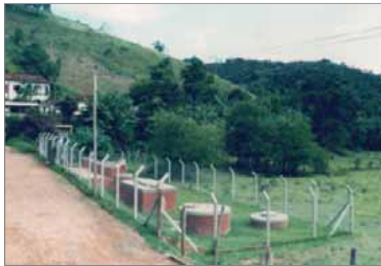
Figura 12. Fotografía instalaciones de tratamiento anaeróbico de película fija.
