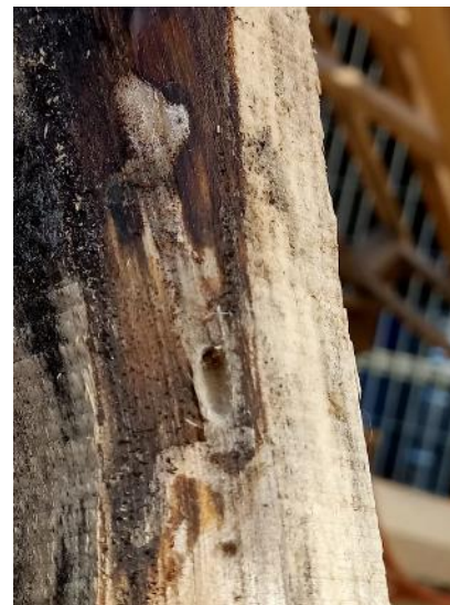
Daño producido por Pissodes piniphilus (Fotografía: SAG)
